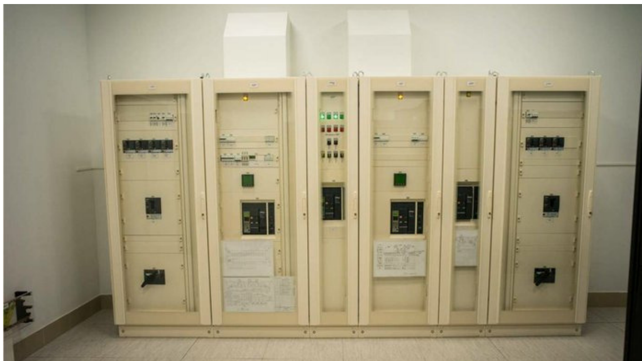
Распределительный шкаф Prisma P
